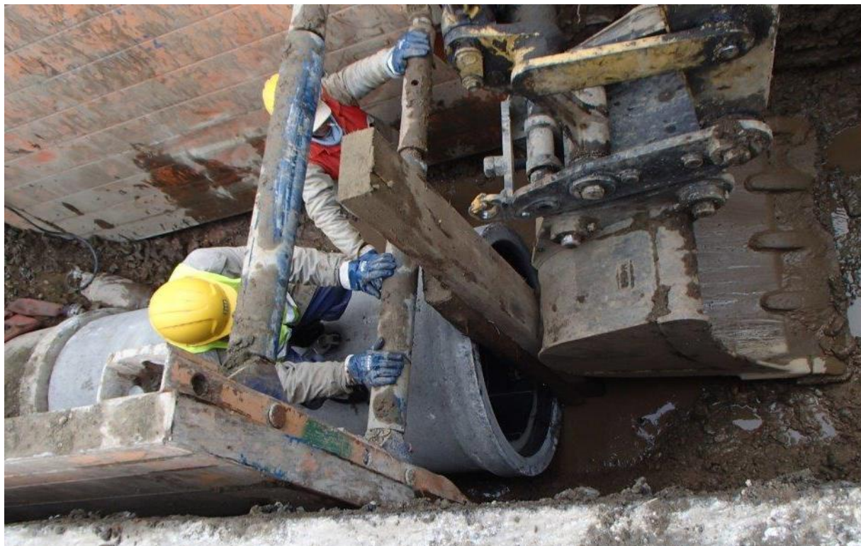
Obr. P3.3 – Na dřevěný trámek se vyvine tlak stavební mechanizací, např. bagr, tak aby došlo k zatlačení na trubu v její podélné ose
