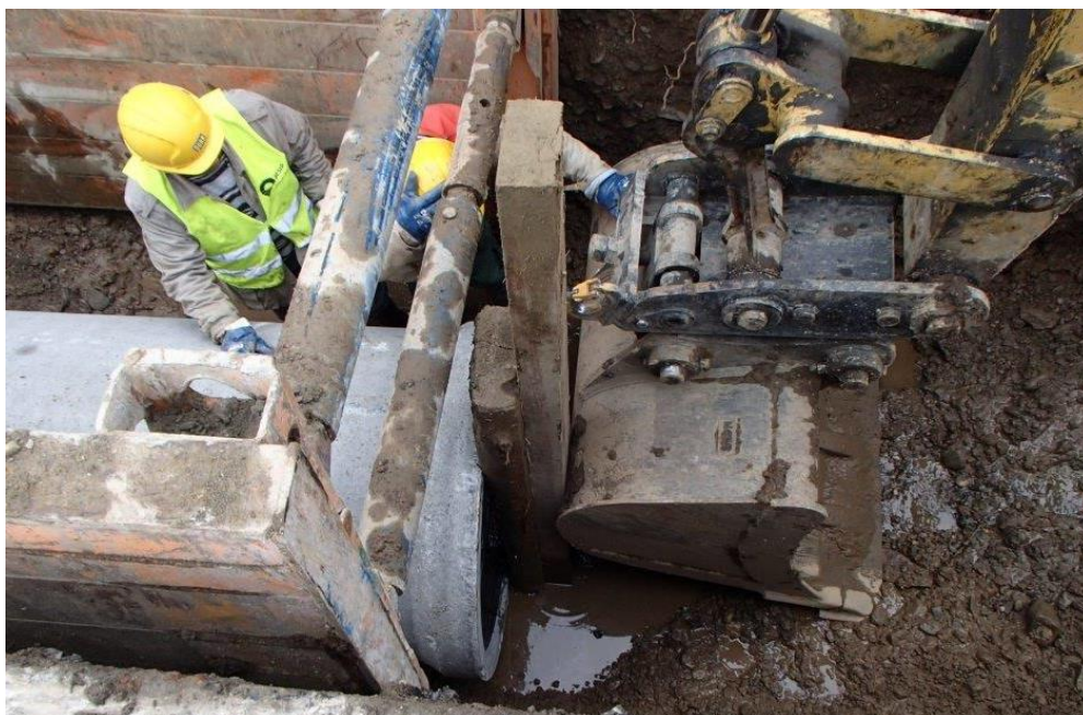
Obr. P3.2 – Na dřevěný trámek se opře rameno staveništní mechanizace, např. bagru, tak aby nedošlo ještě k zatlačování a zároveň aby trámky byly zajištěny před pádem.
